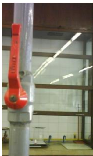
Slika 2. OTVOREN PLINSKI VENTIL – ventil je PARALELAN s plinskom cijevi
